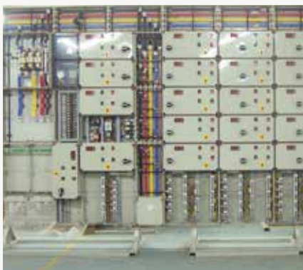
Centre de commande des moteurs installé dans une grande usine de papier
