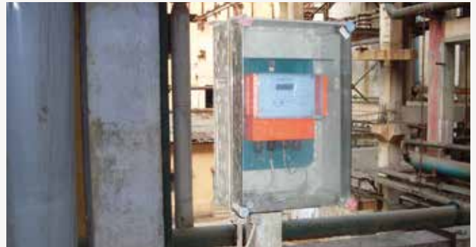
Enceinte d'instruments dans une station de pompage
