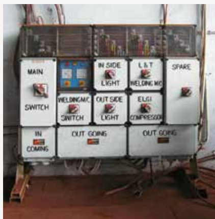
+ Tableau de distribution électrique installé dans un atelier de maintenance d'une mine de fer
