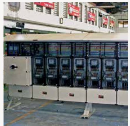
+ Panneau avec compteurs kWh pour une compagnie d'électricité
