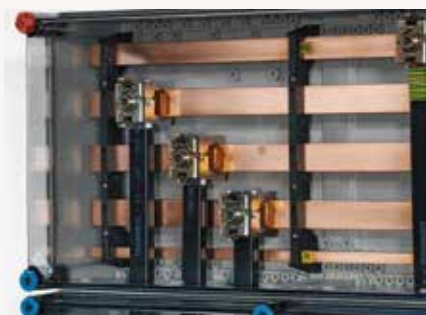
Par exemple, les barres omnibus sont fixées sur des supports en matériau isolant.
