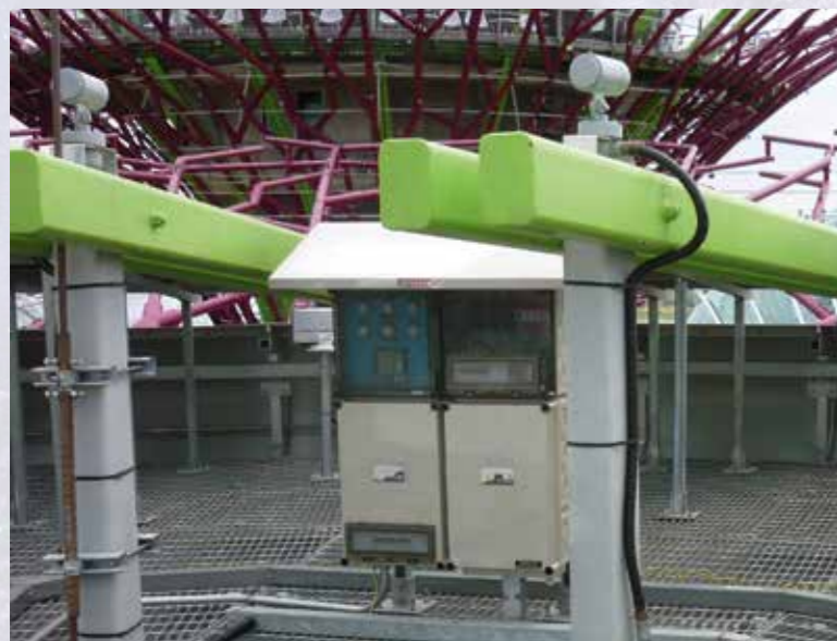
新加坡的擎天树上安装了光伏逆变器汇流箱。
