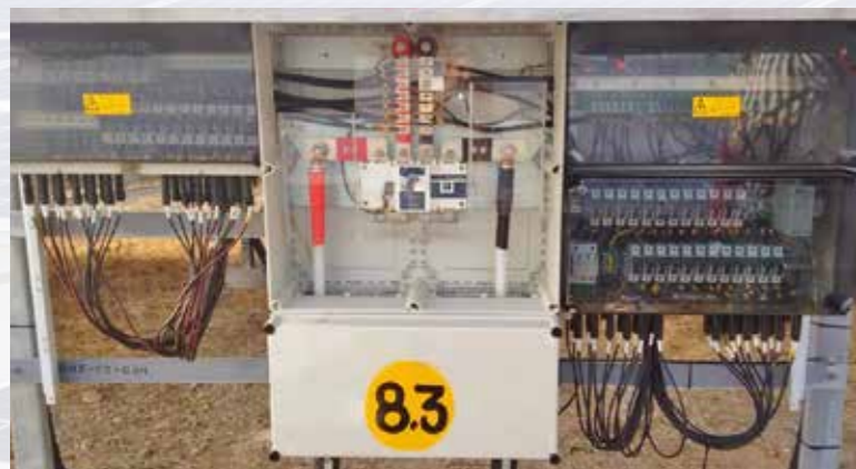
印度金奈光伏电厂扩建后的光伏配电箱。
