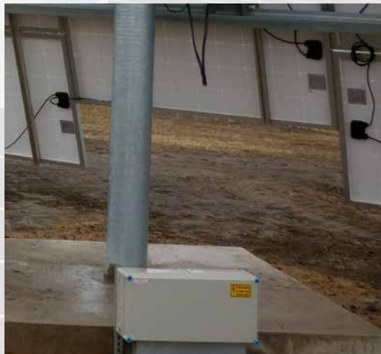
在匈牙利Újszilvás的太阳能发电园区中，众多的太阳能跟踪器每年产生635000 kWh的电量。逆变器采用汉森个性化产品解决方案进行连接。
