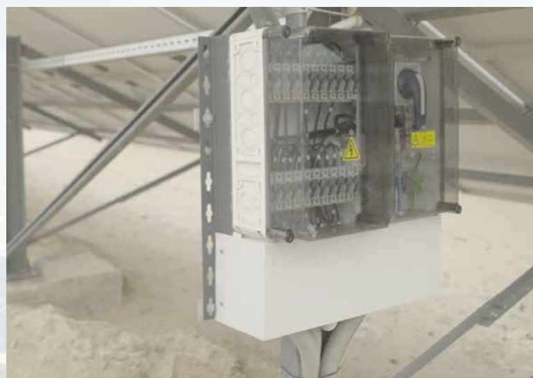
光伏配电箱靠近沙漠水源，用于独立于电网的水泵系统
