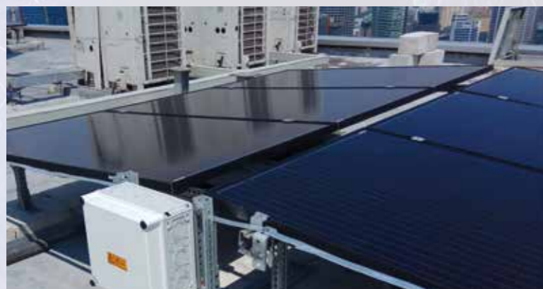
滨海湾金沙酒店屋顶上安装了众多光伏发电汇流箱。
