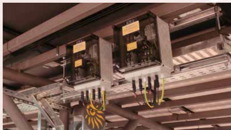
众多的汉森光伏发电汇流箱确保光伏发电可靠配电。
