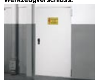
... durch abgeschlossenen, elektrischen Betriebsraum
