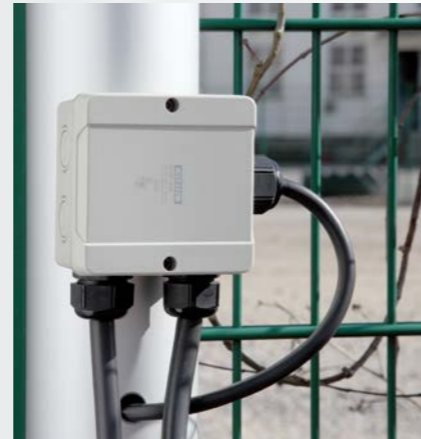
Bodennahe ungeschützte Installation im Freien
