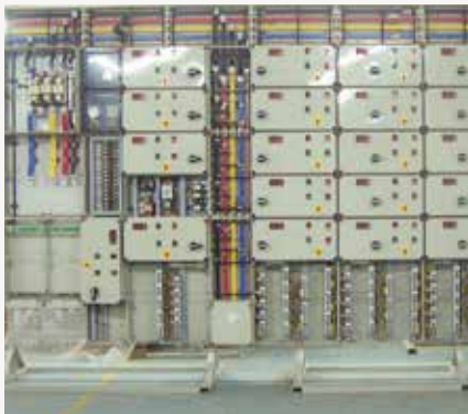
Moottorin ohjauskeskus asennettuna suurelle paperitehtaalle
