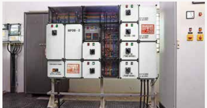
Valimoon asennettu pääsähkönjakokeskus
