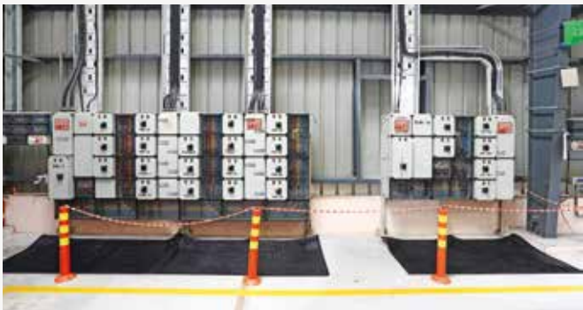
Tarkkuusmekaniikanteollisuuteen asennetut sähkönjakokeskukset
