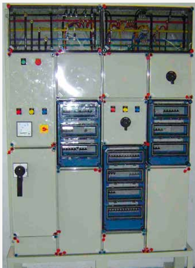
Huoltoaseman sähkön pääjakokeskus
