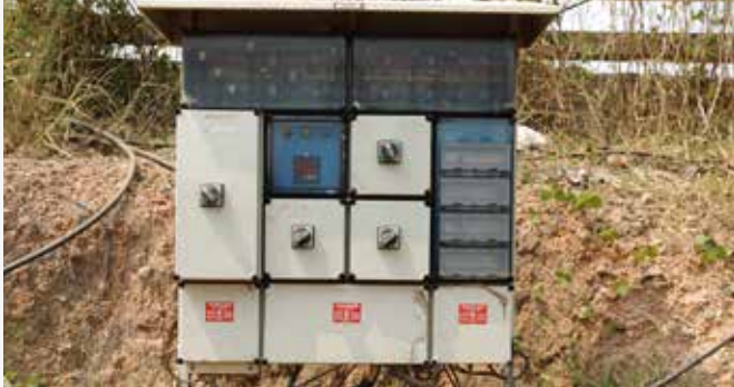
Vesivoimalaitokselle asennettu alijakokeskus.
