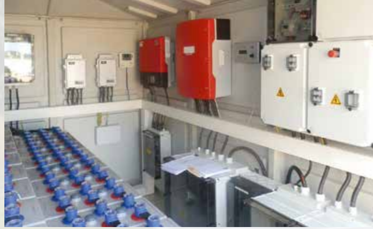
Liberya'da bir köyün PV jeneratör bağlantı kutuları, PV güç çevirici (inverter) kolektörleri ve akü gruplarını korumak için akü dağıtıcıları ile elektrikleştirilmesi
