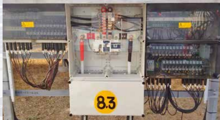
Hindistan, Chennai'deki bir PV tesisinin genişletilmesinden sonra PV dağıtım panoları.
