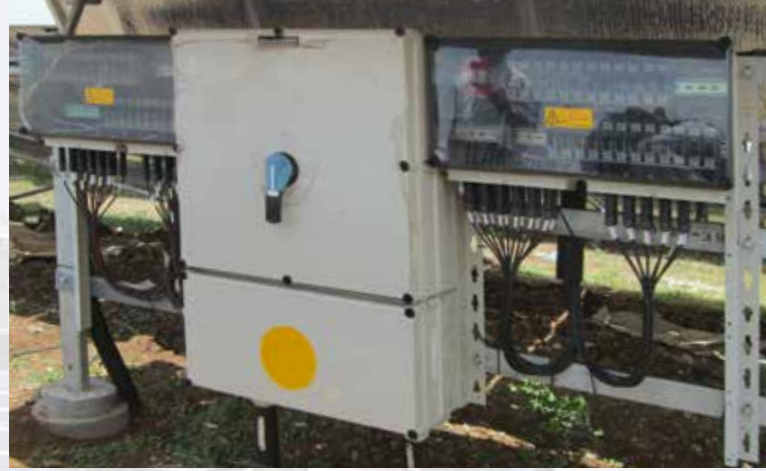
Hindistan, Chennai'deki bir tesisin genişletilmesinden önce PV dağıtım panoları.
